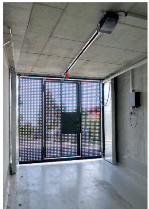
Innenansicht einer nicht-ausschwenkenden Sammelgaragentoranlage
